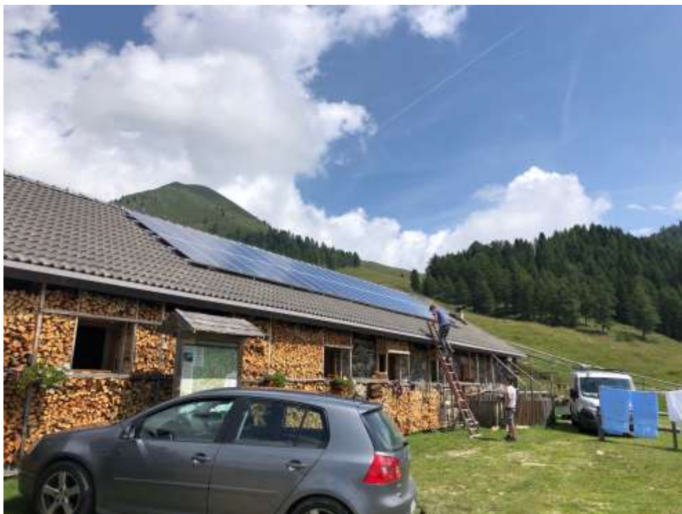
particolare impianto fotovoltaico da 6,4 kWp
